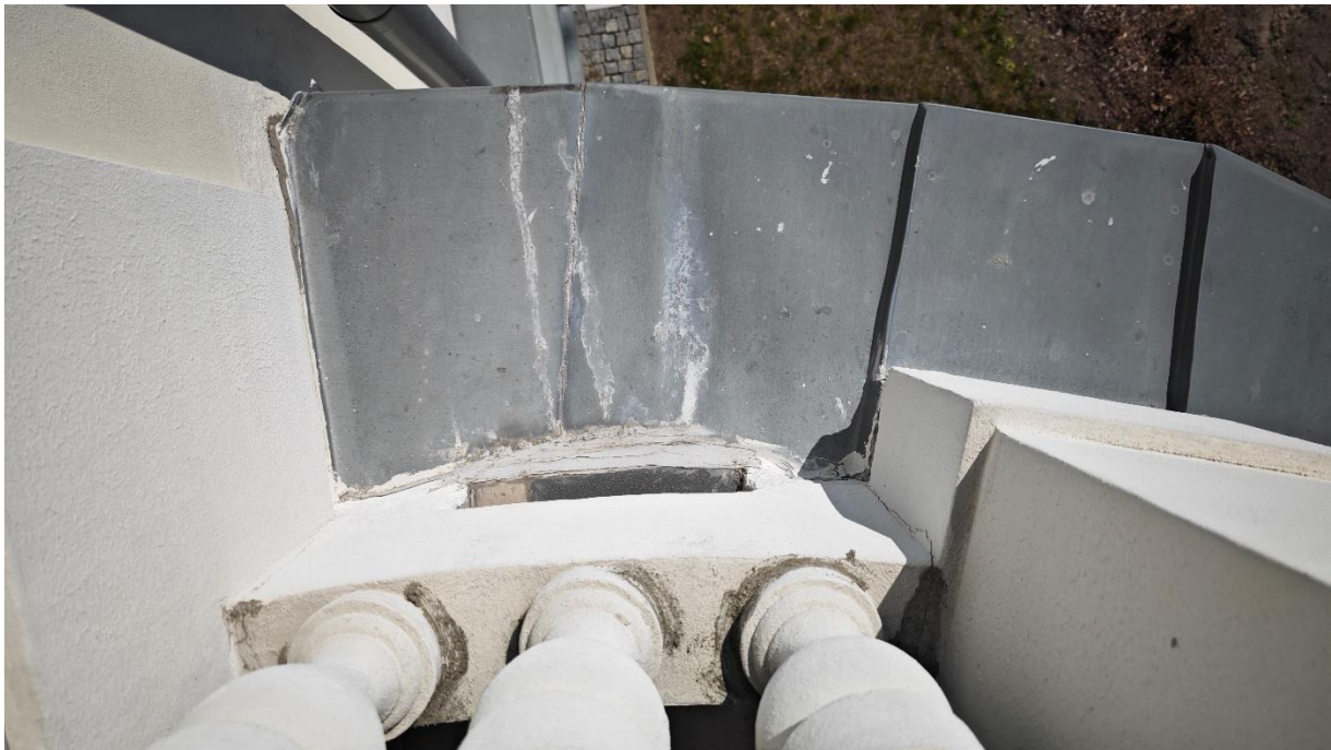
Zdjęcie 25. Na powierzchni blachy widoczne są ślady intensywnego zabrudzenia, przebarwień i zacieków, świadczące o nieprawidłowym odprowadzaniu wody. Zgrzewy i łączenia wykazują ślady nieszczelności, miejscami doszło do pęknięć i rozwarstwień. Na powierzchni tynku w bezpośrednim sąsiedztwie balustrady widoczne są rysy i ubytki w miejscach połączeń oraz ślady napraw zaprawą o odmiennej fakturze i barwie.
