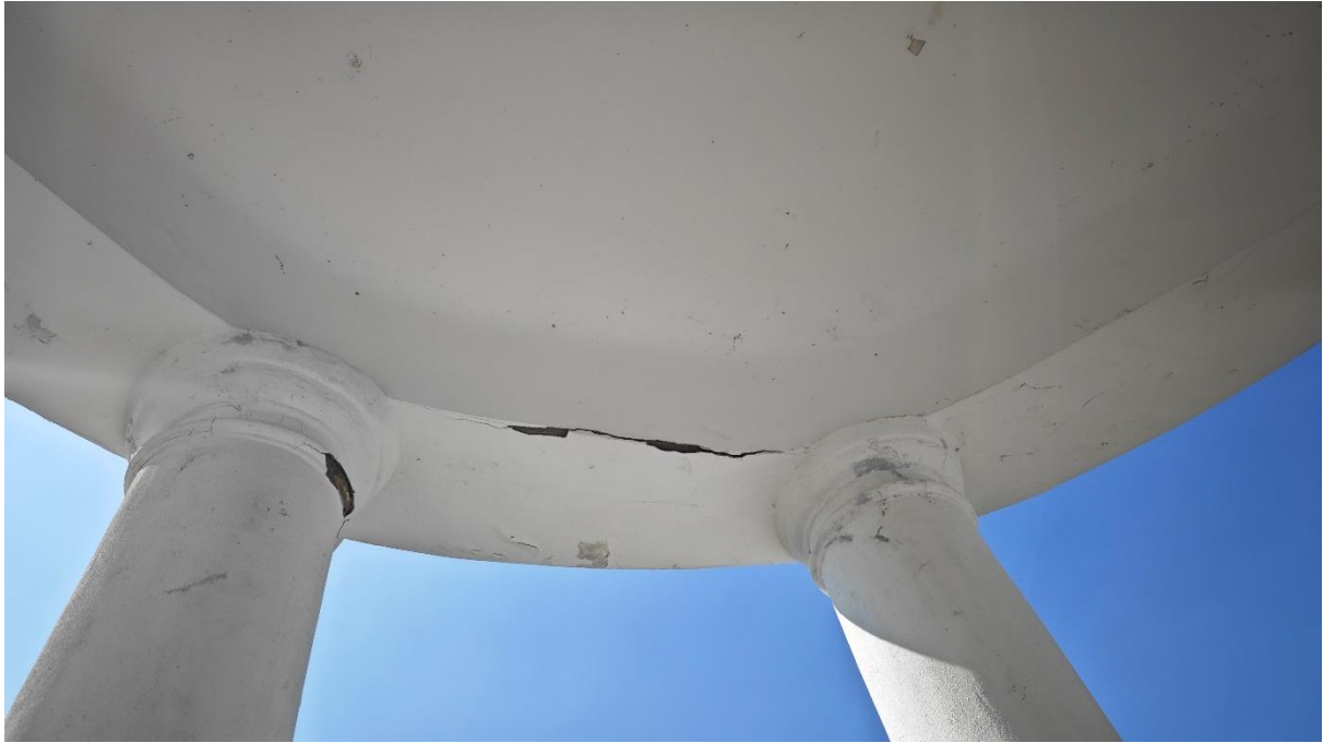
Zdjęcie 15. Na spodzie płyty balkonowej widoczne są liczne rysy i spękania biegnące wzdłuż linii oparcia balkonu na kolumnach. W środkowej części zaznacza się głębsze pęknięcie z ubytkiem tynku. Dodatkowo widoczne są przebarwienia i miejscowe zabrudzenia powierzchni oraz uszkodzenia krawędzi głowic kolumn.
