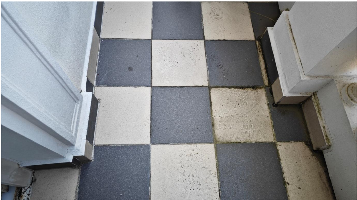
Zdjęcie 23. Widoczne są liczne zabrudzenia i przebarwienia na powierzchni płytek ceramicznych oraz w spoinach, szczególnie w strefie przyściennej i przy cokole balustrady. Fugi wykazują ubytki i nieszczelności, miejscami doszło do ich całkowitego wypłukania. Na powierzchniach pionowych przy styku z posadzką widoczne są zawilgocenia oraz naloty biologiczne.
