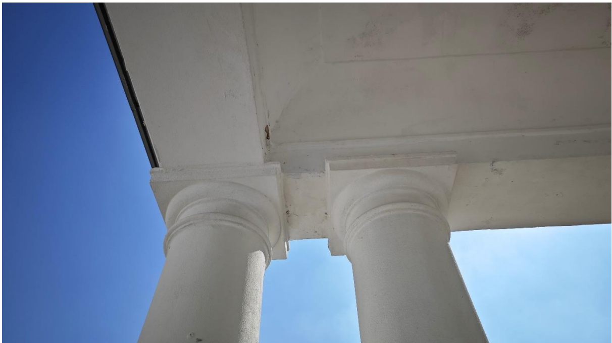
Zdjęcie 19. Na powierzchni spodniej płyty balkonowej widoczne są liczne przebarwienia i osady wskazujące na zawilgocenie. W strefie styku belki z głowicami kolumn oraz w narożach występują pęknięcia tynku i miejscowe jego odspojenia. Zauważalne są również rysy biegnące wzdłuż krawędzi płyty.
