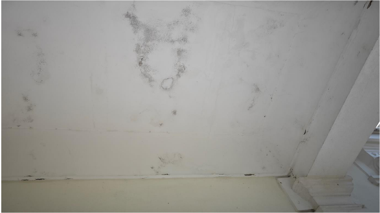
Zdjęcie 18. Na spodzie płyty balkonowej widoczne są liczne przebarwienia i zacieki świadczące o zawilgoceniu, a także ślady miejscowego rozwoju pleśni i grzybów. W dolnych partiach obserwuje się także spękania wzdłuż krawędzi oraz odspojenia tynku wzdłuż linii styku z elewacją.
