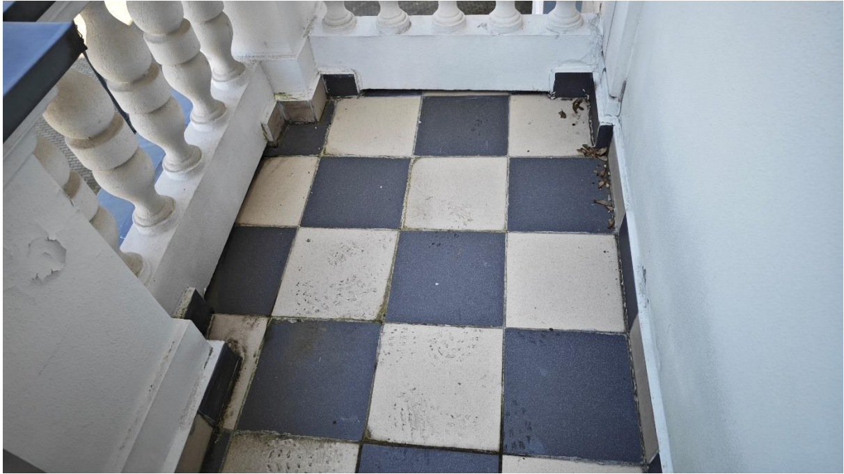
Zdjęcie 22. Na powierzchni płytek ceramicznych widoczne są liczne zabrudzenia i przebarwienia, zwłaszcza w spoinach, które miejscami wykazują oznaki porostania oraz nieszczelności. W rejonie narożników i przy połączeniach z cokołami balustrady widoczne są uszkodzenia tynku, drobne pęknięcia oraz odspojenia warstw wykończeniowych. W niektórych miejscach fuga jest wykruszona, a przy styku z elewacją i tralkami widoczne są ślady zawilgocenia.
