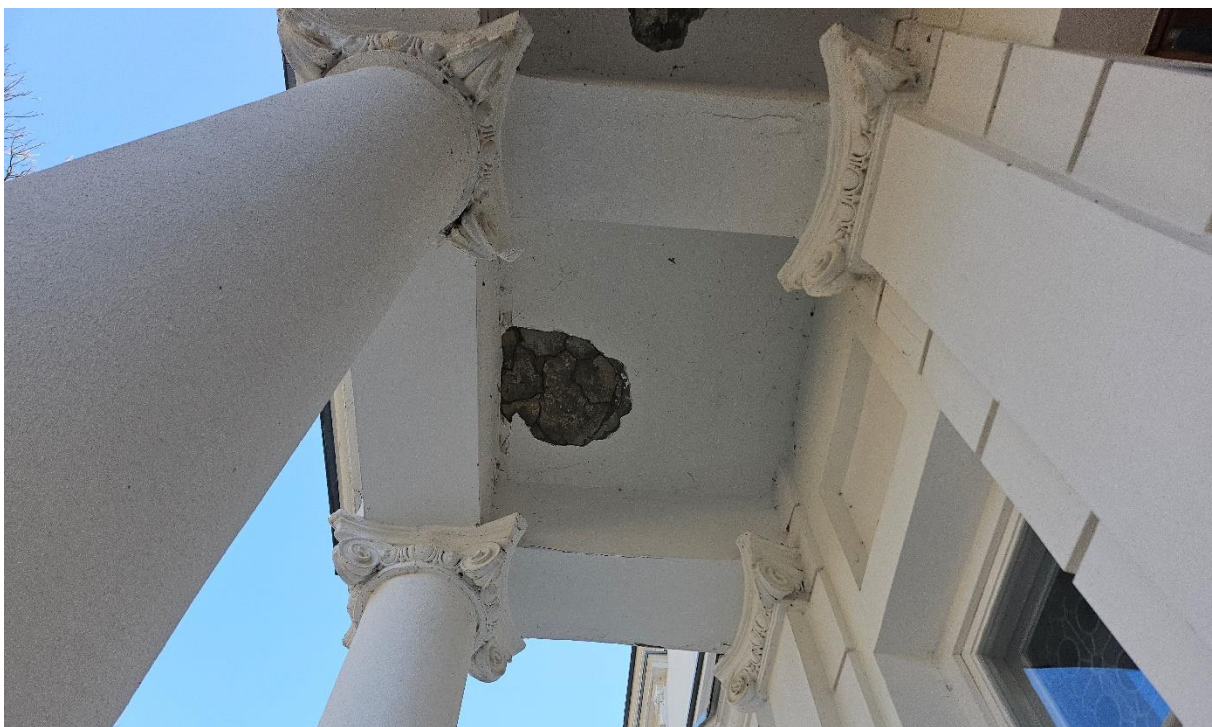
Zdjęcie 14. Widoczne są głębokie ubytki tynku na spodzie płyty balkonowej, odsłaniające spękaną strukturę płyty. Powierzchnia tynku wokół uszkodzeń jest spękana, a w narożnikach zaznaczają się zarysowania. Na elementach sztukatorskich występują drobne uszkodzenia i zabrudzenia.
