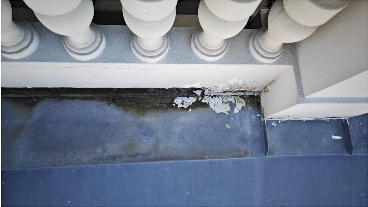
Zdjęcie 20. Widoczne są odspojenia i złuszczenia warstw malarskich oraz tynku u podstawy balustrady tralkowej, ze skupieniem uszkodzeń w narożniku przy styku z obróbką blacharską. Na powierzchni blachy widoczne są zacieki i ciemne przebarwienia świadczące o zaleganiu wody oraz potencjalnym przeciekaniu w tym miejscu.
