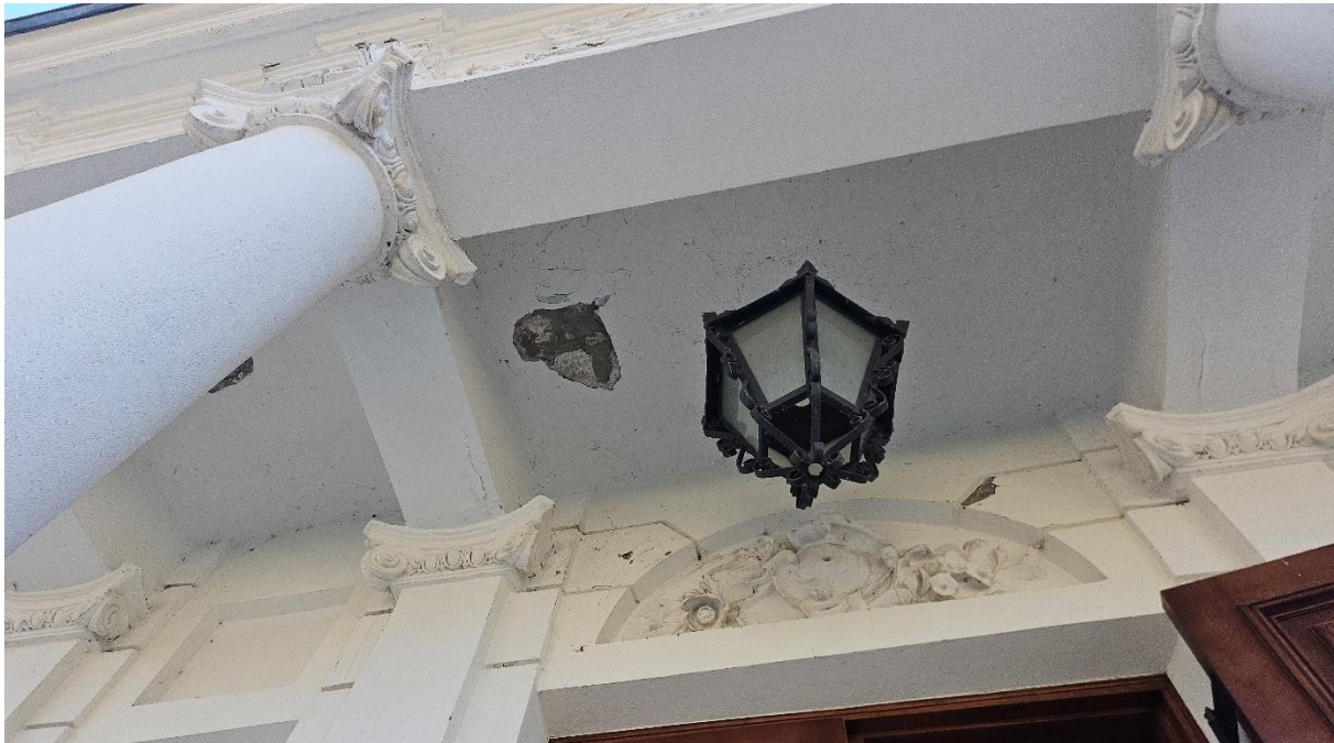
Zdjęcie 13. Spód płyty balkonowej nad głównym wejściem na elewacji frontowej pałacu. Na zdjęciu widoczne są ubytki tynku na spodzie płyty balkonowej, w tym większe odspojenia sięgające warstwy konstrukcyjnej. Występują również pęknięcia i rysy wzdłuż linii belek oraz ubytki przy detalach sztukatorskich nad drzwiami. Powierzchnia jest miejscowo zabrudzona i zanieczyszczona, widoczne są ślady przesiązków.
