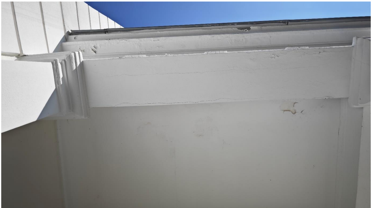
Zdjęcie 16. Na powierzchni spódnej balkonu widoczne są podłużne, poziome spękania tynku przebiegające wzdłuż całej długości gzymsu, a także drobniejsze spękania i wykruszenia w strefie przylegającej do krawędzi. W górnej części tynku zaobserwować można odspojenia i miejscowe ubytki warstw wykończeniowych.
