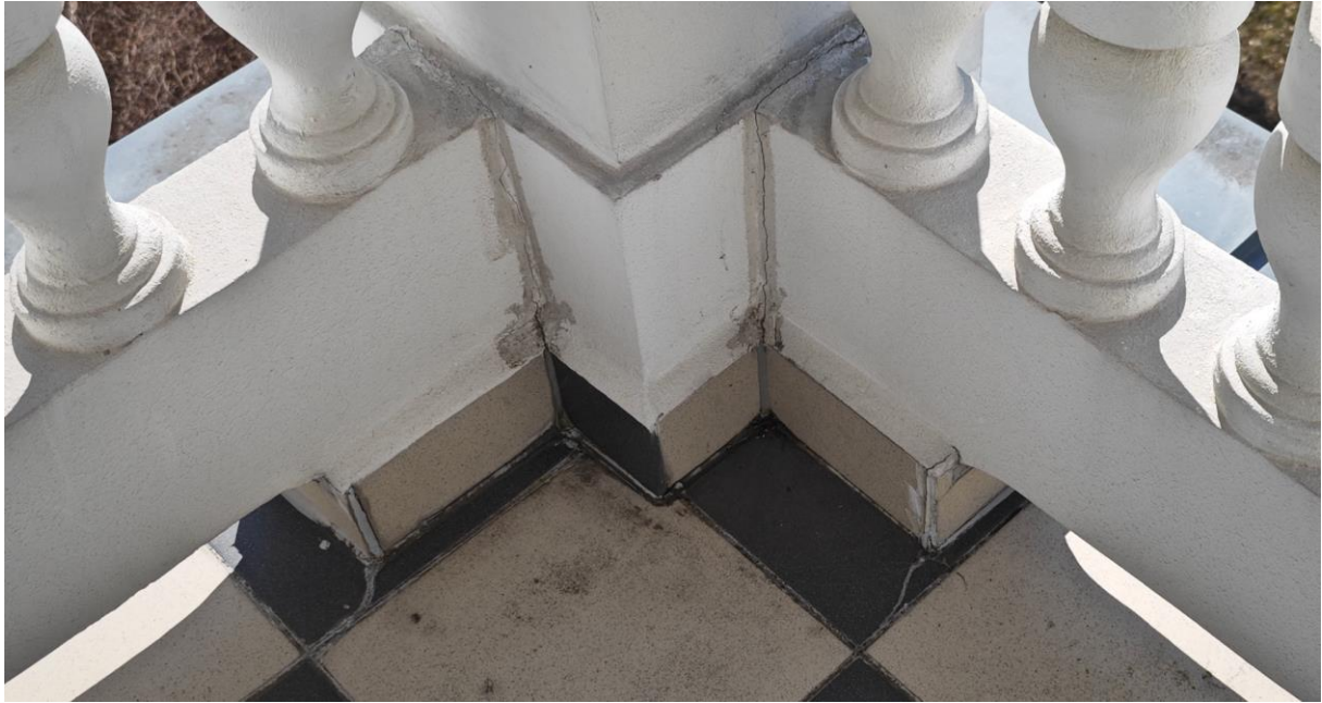
Zdjęcie 26. Na powierzchni cokołów i narożników murków balkonowych widoczne są liczne spękania oraz ślady wcześniejszych, nieestetycznych napraw wykonanych zaprawą o innej fakturze i kolorze. Fugi między płytkami ceramicznymi są zanieczyszczone i miejscami rozmyte, a niektóre naroża wykazują ubytki. Widoczne są także zabrudzenia i ślady zawilgocenia przy stykach okładziny z murem.
