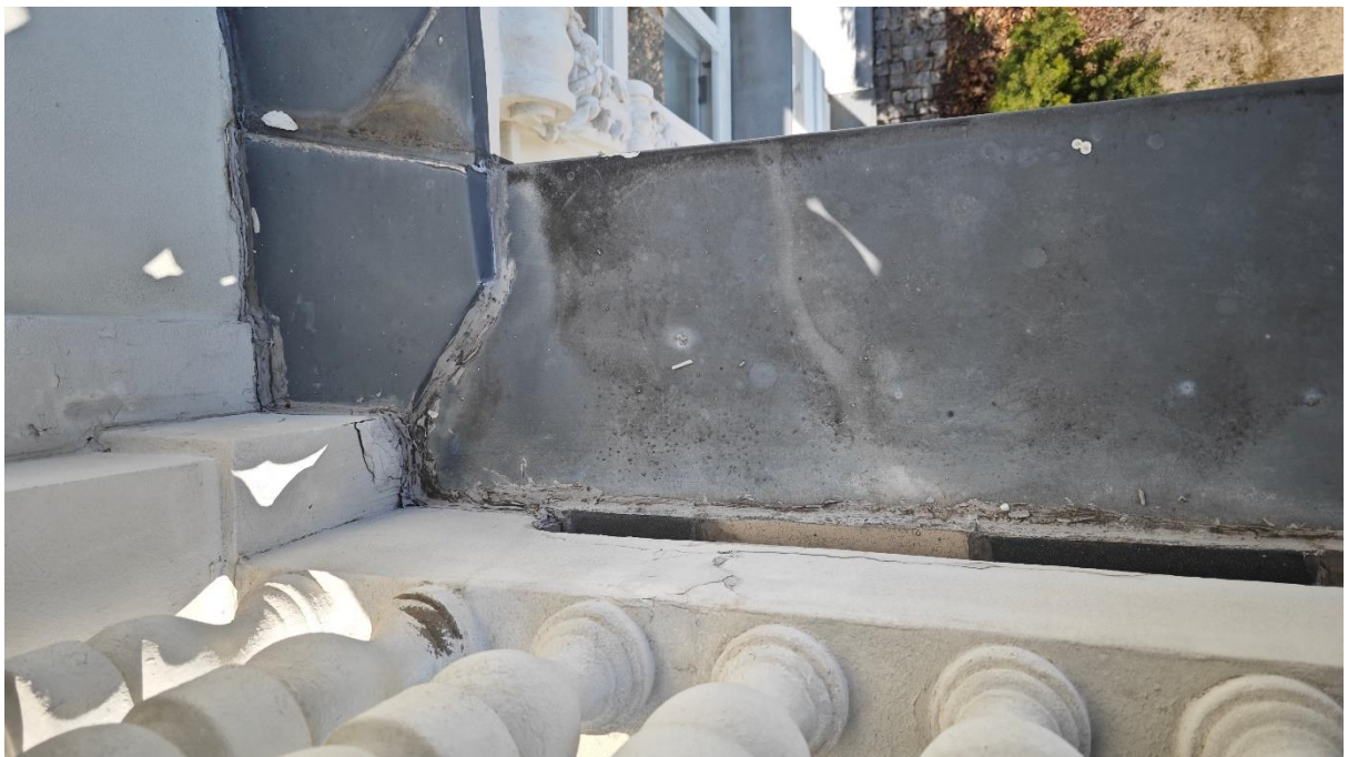
Zdjęcie 27. Widoczne są zabrudzenia i odbarwienia powierzchni blachy, nieszczelności na łączeniach oraz popalowania arkuszy. W miejscach styku obróbek z murem występują ubytki zaprawy i liczne spękania tynku, a także deformacje i nieszczelności wzdłuż krawędzi pokrycia, co może świadczyć o niefachowym montażu lub zużyciu materiału.
