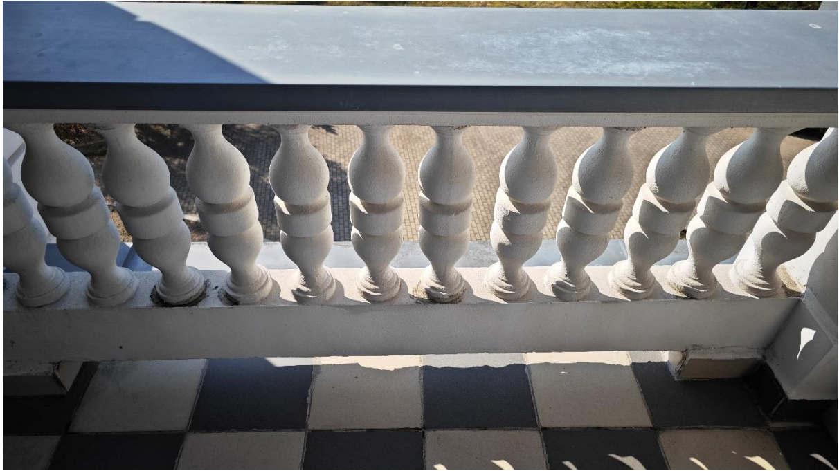
Zdjęcie 24. Na powierzchni tralek balustrady widoczne są lokalne zabrudzenia, przebarwienia oraz ślady nalotów biologicznych, szczególnie u podstawy. W miejscach styku tralek z dolną belką balustrady widoczne są drobne spękania i ubytki zaprawy. Część połączeń wykazuje nieszczelności, które mogą sprzyjać penetracji wody.
