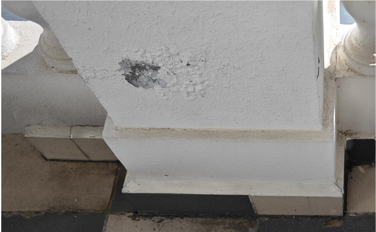
Zdjęcie 28. Widoczne punktowe uszkodzenie powierzchni wyprawy tynkarskiej z odspojeniami i puchłami. W dolnej części widoczne również spękania i ubytki przy krawędzi cokołu oraz zabrudzenia wzdłuż linii styku z posadzką.
