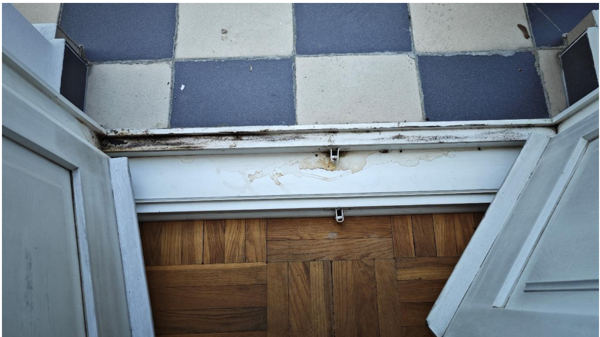
Zdjęcie 29. Strefa wejścia na balkon na piętrze w części frontowej. Na zdjęciu widoczny jest dolny fragment ościeżnicy drzwi balkonowych wraz z progiem i fragmentem posadzki wewnętrznej. Zauważalne są istotne ślady zawilgocenia i degradacji drewna w strefie progu – występują przebarwienia, łuszcząca się powłoka malarska oraz ślady korozji metalowych elementów okuć. Uszkodzenia te świadczą o nieszczelnościach izolacji przeciwwodnej balkonu i przedostawaniu się wody do wnętrza budynku. Widoczne są także zanieczyszczenia i ciemne wykwity w spoinach między płytkami przy progu.
