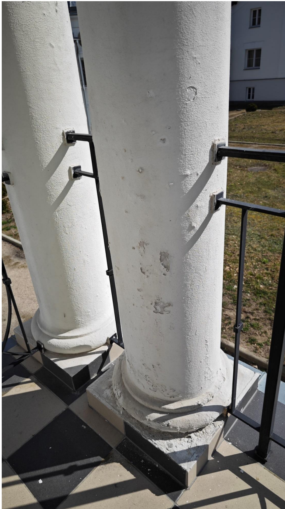
Zdjęcie 17. Na powierzchni kolumny widoczne są liczne ubytki tynku, szczególnie w dolnych partiach trzonu oraz na bazie, gdzie doszło do znacznego wykruszenia wyprawy i częściowo materiału podłoża. Na całej powierzchni kolumny zaobserwować można punktowe uszkodzenia oraz miejscowe zabrudzenia.
