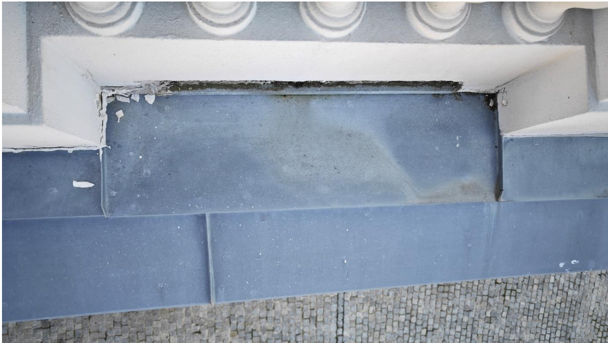
Zdjęcie 21. W górnej partii zdjęcia widoczne są odspojenia tynku balustrady łuszczenie się warstwy malarskiej w narożnikach cokołu balustrady, z towarzyszącym przebarwieniem i śladem zawilgocenia przy linii styku z blachą. Obróbka blacharska wykazuje miejscowe odbarwienia, zacieki i zabrudzenia powierzchni, a połączenia arkuszy wskazują na brak szczelności lub nieprawidłowy montaż.
