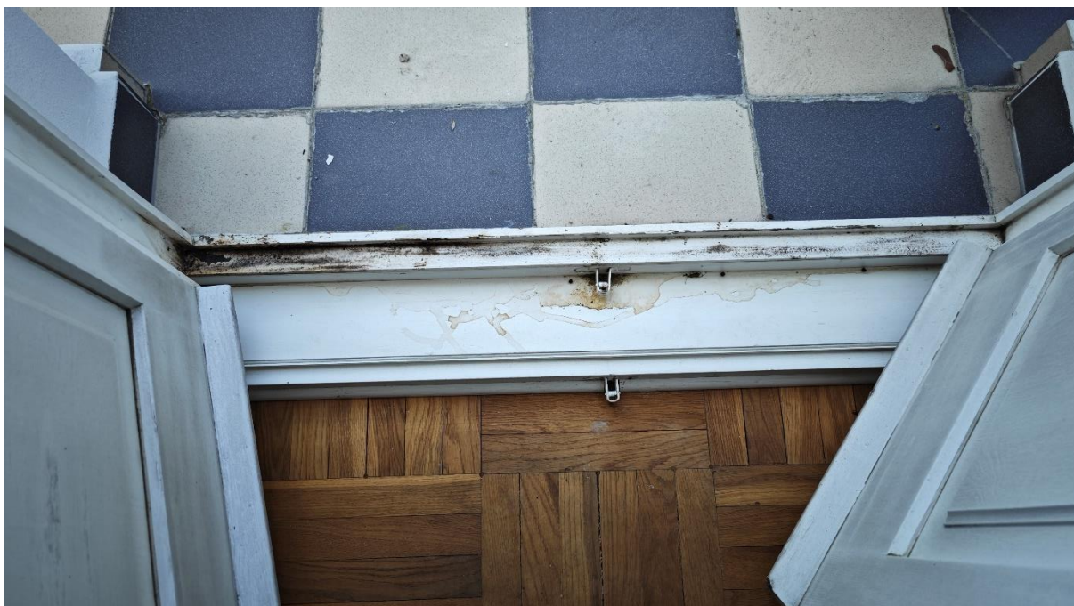
Zdjęcie 16. Fragment progu wejściowego na balkon w pałacu. Widoczne ślady degradacji drewna i farby na wewnętrznej stronie ramy drzwiowej oraz zawilgocenie i przebarwienia w obrębie styku posadzki z parkietem wskazują na przecieki. Woda opadowa zalegająca na powierzchni balkonu w czasie intensywnych deszczy przedostaje się do wnętrza, powodując stopniową degradację drewna. Konieczne jest uszczelnienie progu i poprawa odwodnienia balkonu.
