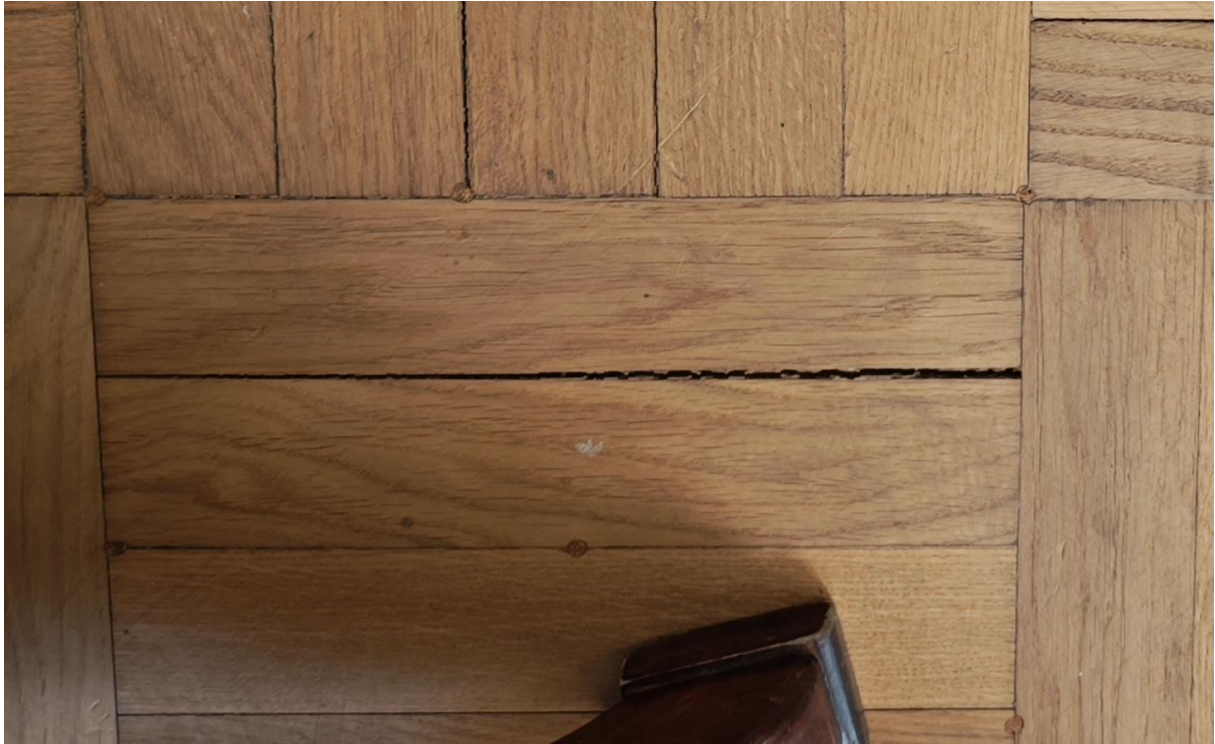
Zdjęcie 7. Zbliżenie fragmentu parkietu z wyraźnie widoczną szczeliną między klepkami, powstałą najprawdopodobniej na skutek pracy drewna spowodowanej zmianami wilgotności powietrza. Dodatkowo zauważalne są miejscowe zarysowania powierzchni oraz niewielkie zaflekowania w narożnikach, świadczące o wcześniejszych naprawach mechanicznych.
