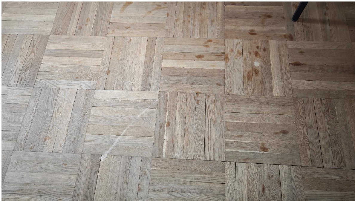
Zdjęcie 1. Widok posadzki z klepek dębowych ułożonych w układzie szachownicowym. Na powierzchni widoczne liczne miejscowe plamy o nieregularnym kształcie i ciemniejszym zabarwieniu, prawdopodobnie wynikające z kontaktu z tłustym lub barwiącym płynem. W centralnej części zdjęcia zauważalne pojedyncze, jaśniejsze odbarwienia (m.in. długi, łukowaty ślad i okrągła plama), które mogą być skutkiem działania substancji wybielającej. Parkiet wykazuje miejscowe zmatowienia i utratę jednolitego wykończenia powierzchni, co wskazuje na zużycie warstwy ochronnej.
