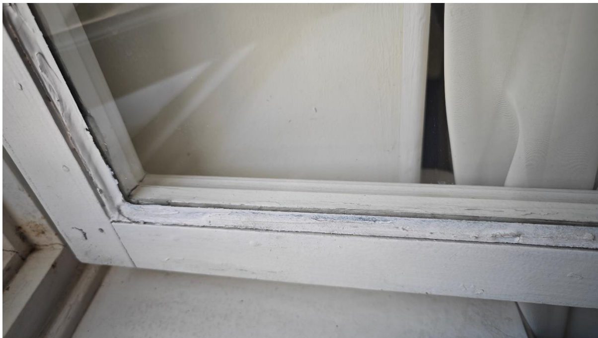
Zdjęcie 3. Fragment skrzydła okiennego z wyraźnie zdegradowanym kitem osadczym – widoczne są jego spękania, wykruszenia i niestaranna aplikacja. W wyniku utraty przyczepności kitu, szyba porusza się luźno w ramie, co może prowadzić do dalszych uszkodzeń mechanicznych lub wypadnięcia szkła. Widoczne są także lokalne ubytki powłoki malarskiej oraz zabrudzenia przy krawędziach.
