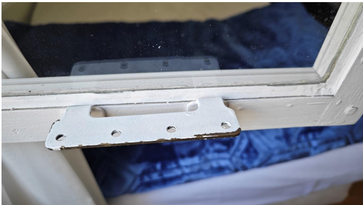
Zdjęcie 2. Zbliżenie na element okuć okiennych – zasuwkę montowaną w dolnej części skrzydła. Widoczne są liczne uszkodzenia powłoki malarskiej, w tym odpryski i przetarcia do metalu, a także nierównomierne nałożenie farby, co sugeruje wtórne, nieprofesjonalne przemalowanie bez odpowiedniego przygotowania podłoża. Obecny stan może wpływać na estetykę, ale także na trwałość elementu – brak zabezpieczenia antykorozyjnego grozi dalszą degradacją metalu.
