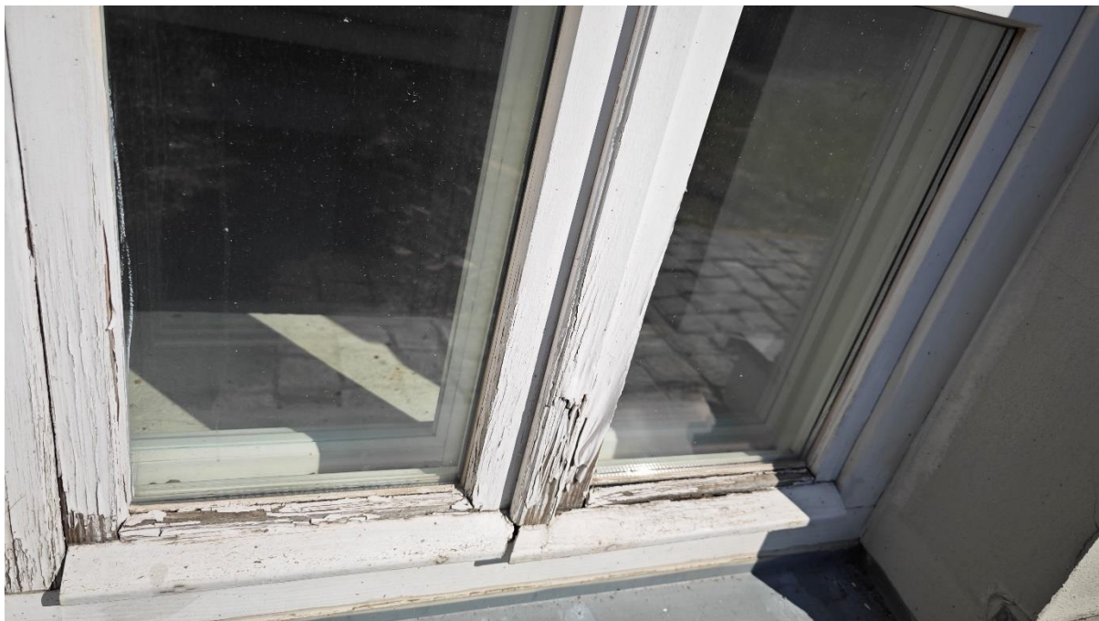
Zdjęcie 6. Zbliżenie dolnej partii skrzydła okiennego od strony zewnętrznej. Widoczne są zaawansowane uszkodzenia powłoki malarskiej oraz rozwarstwienia drewna w dolnej części ramiaka, świadczące o długotrwałym działaniu wilgoci. Dodatkowo widoczne są ślady korozji biologicznej i ubytki kitu przy osadzeniu szyby.
