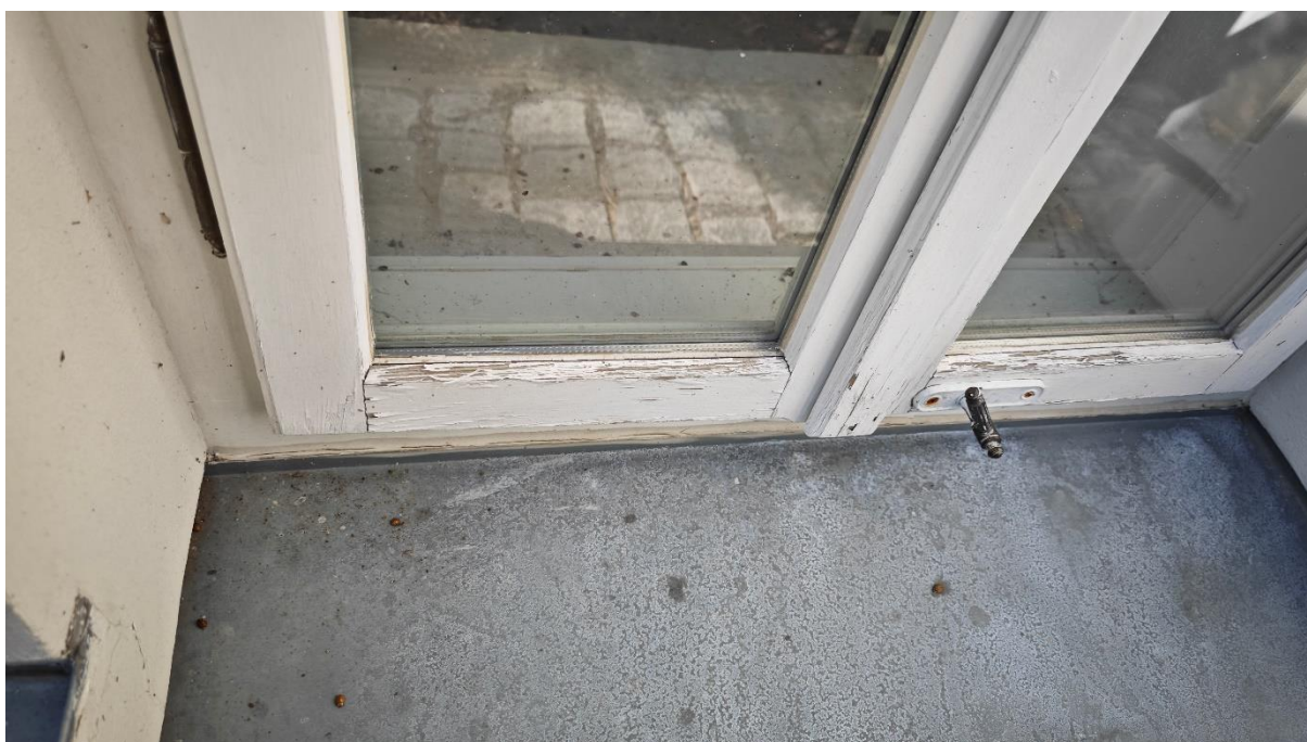
Zdjęcie 8. Fragment dolnej partii skrzydeł drzwi balkonowych w elewacji ogrodowej. Widoczne są zniszczenia powłoki malarskiej na dolnych listwach oraz uszkodzenia drewna wynikające z długotrwałego kontaktu z wilgocią. W obrębie zamka dostrzegalne są także ślady korozji metalowego elementu.
