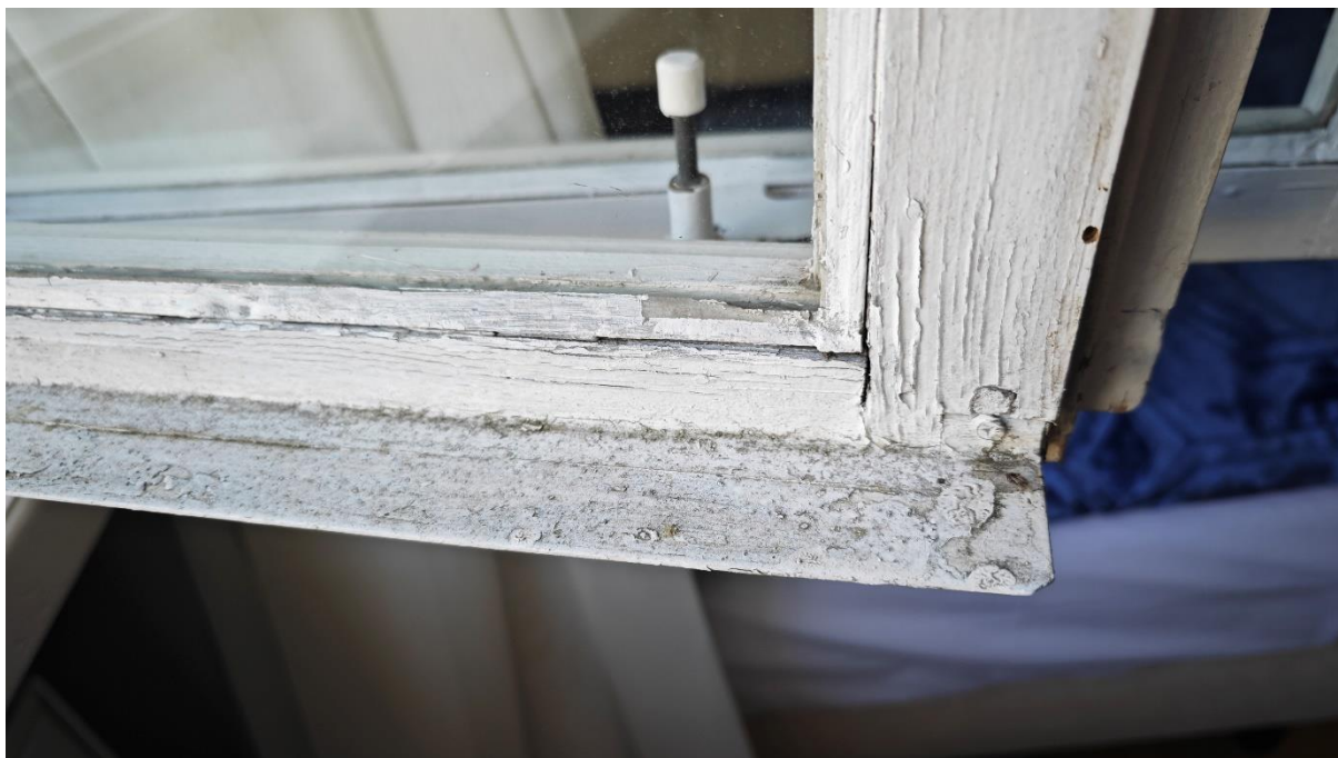
Zdjęcie 1. Dolna część okna drewnianego w oficynie, od strony wnętrza, w obrębie skrzydła zewnętrznego. Na zdjęciu widoczne jest zniszczenie warstwy malarskiej i pęknięcia kitu osadzenia szyby. Miejscami farba złuszcza się, a podłoże jest zabrudzone i zawilgocone. Widoczny jest także nalot biologiczny i ciemne plamy na dolnej listwie przyszybowej.
