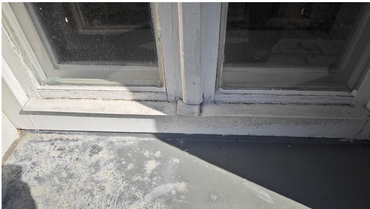
Zdjęcie 5. Zbliżenie na dolny fragment zewnętrznego skrzydła okna. Widoczne pęknięcia i złuszczenia powłoki malarskiej na dolnej listwie przyszybowej oraz uszkodzony i wykruszony kit szklarski, szczególnie wzdłuż krawędzi.
