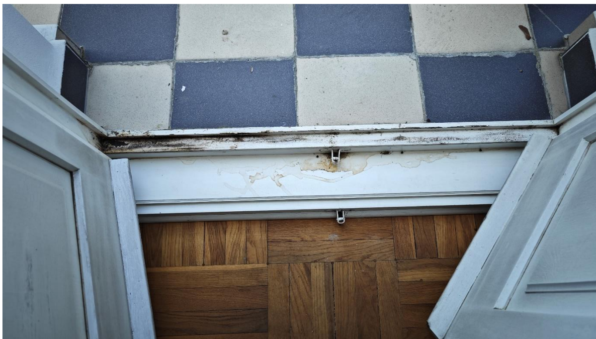
Zdjęcie 9. Fragment progu drzwi balkonowych od strony wnętrza. Widoczne zaawansowane zniszczenia powierzchni stolarki, w tym łuszcząca się i odspojona powłoka malarska, przebarwienia i ślady zacieków po wodzie. Zabrudzenia oraz ślady pleśni w górnej części świadczą o wielokrotnym zalewaniu progu – najpewniej na skutek niesprawnego odwodnienia lub braku spadku posadzki balkonu.
