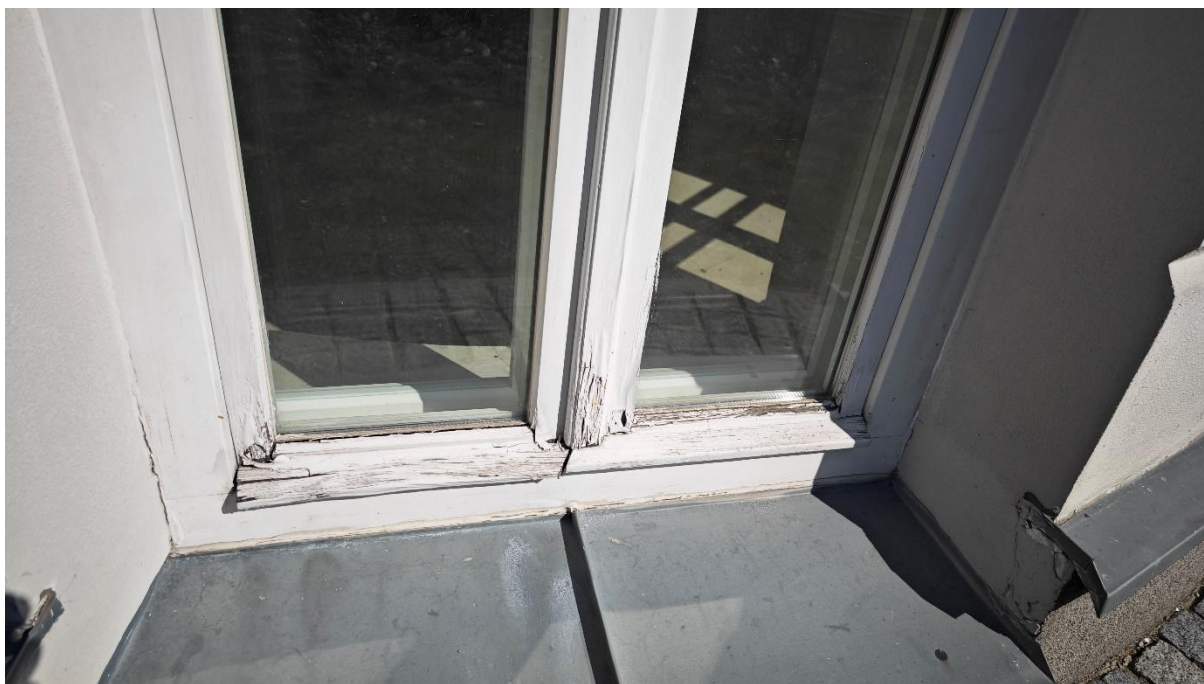
Zdjęcie 7. Widok dolnej części skrzydeł okiennych od strony zewnętrznej. Zauważalne są liczne uszkodzenia powierzchni drewna, zwłaszcza w strefie naroży oraz łuszczenie się powłoki malarskiej. Na styku elementów widoczna jest erozja krawędzi i miejscowe rozwarstwienie drewna, co wskazuje na długotrwałe zawilgocenie oraz brak skutecznej ochrony przed wodą opadową.
