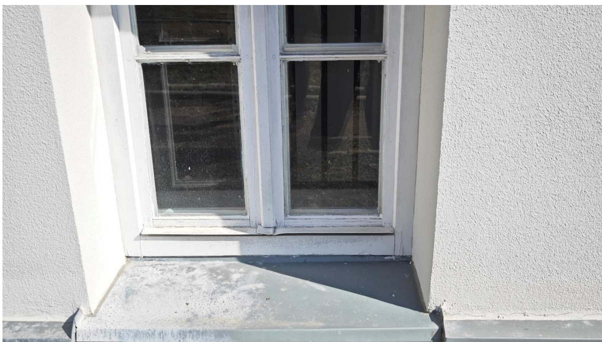
Zdjęcie 4. Widok zewnętrzny na dolną partię okna dwuskrzydłowego w przyziemiu pałacu. Widoczne są uszkodzenia powłoki malarskiej, zarysowania i tuszczenie się farby, zwłaszcza w dolnej części skrzydeł. Kit osadczy wokół szyb jest spękany i częściowo wykruszony. Na parapecie blaszanym występują ślady korozji powierzchniowej i silnych zabrudzeń, co może świadczyć o długo utrzymującej się wilgoci.
